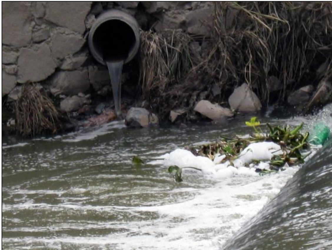
Foto N° 3. Agua sucia en el Canal El Ahogado
